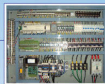
电箱 Electric Box Электронная коробка
